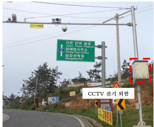
그림 5 CCTV 옥외용 전기함체의 외부 사진
